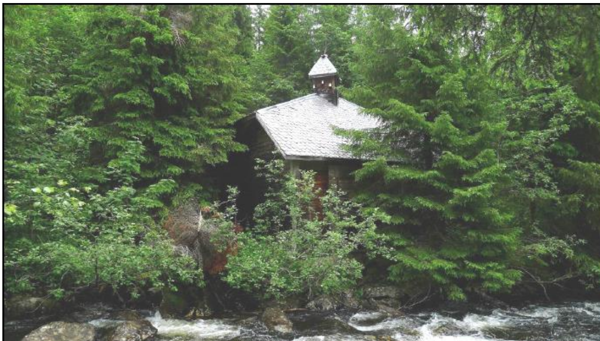
Bygningen er intakt, men ber preg av forfall. Frå befaringssrapport Oppland Fylkeskommune, 2012.
