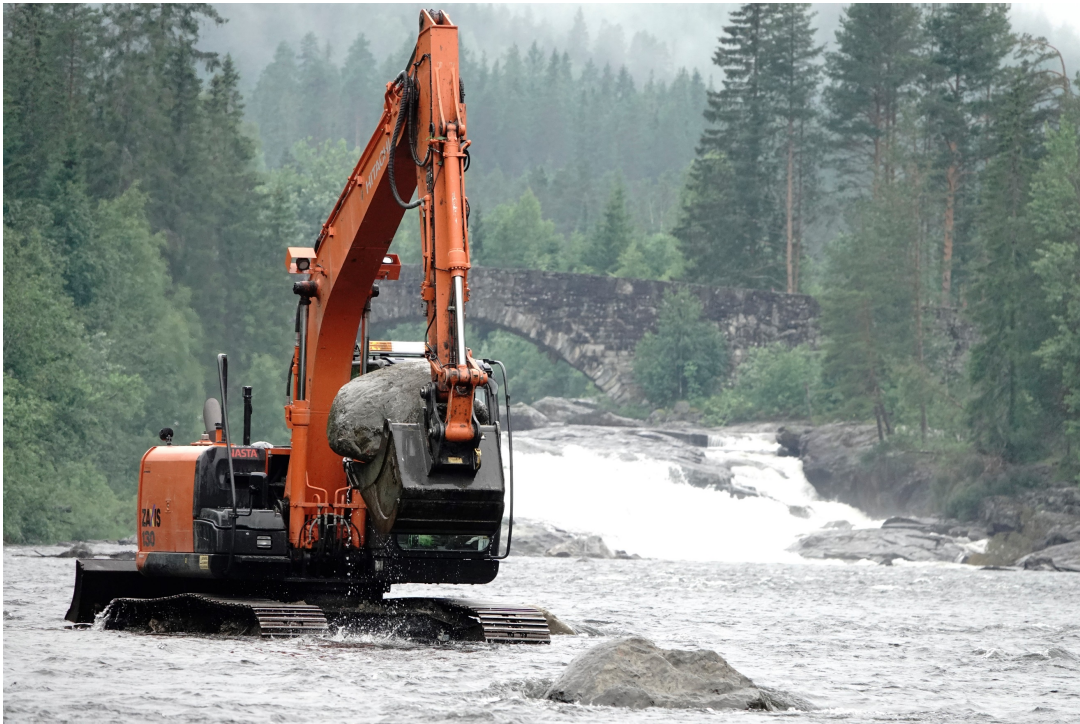
Figur 2 Bildet er tatt under arbeidet med utlegg av stein med gravemaskin, Lundebru i bakgrunn, Nord-Europas største natursteinsbru bygd i 1829 (Foto: G. Høitomt 2022)
